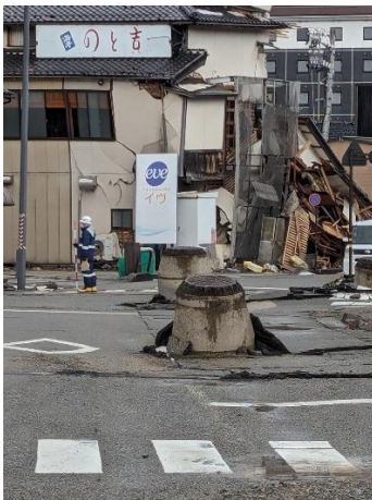
浮き上がったマンホール
